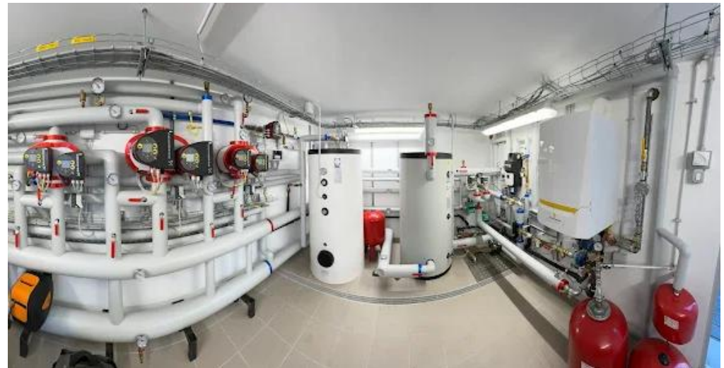
Centrale Termica Mellé – Via Fagnano 27 – Torino
